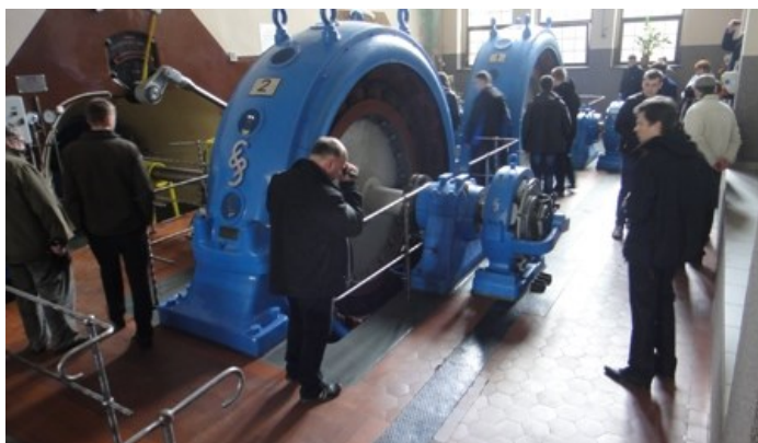
Fot. 3- w Elektrowni Gródek
